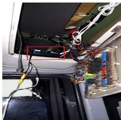
Figura 2 – Interna, dentro da Caixa de Elétrica.
