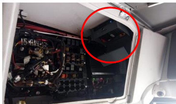
Figura 7 – MDVR com Box dentro da Caixa de Elétrica
