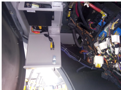
Figura 2 - Interna, dentro da caixa elétrica
